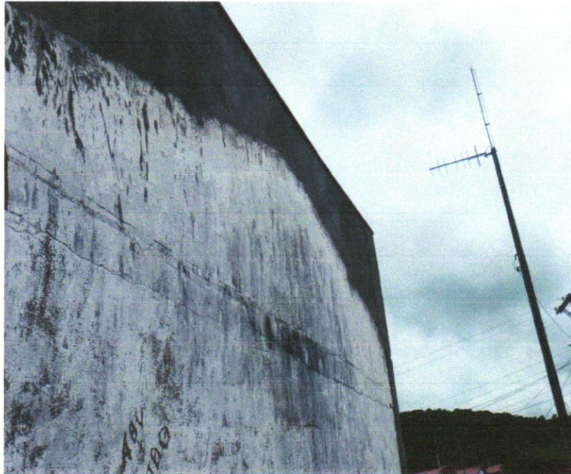
FOTO 03 – Chapim de concreto pré-moldado
