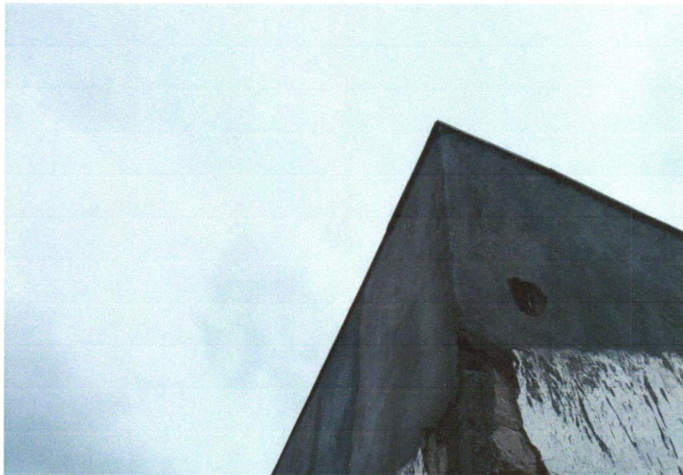
FOTO 04 – Chapim de concreto pré-moldado
